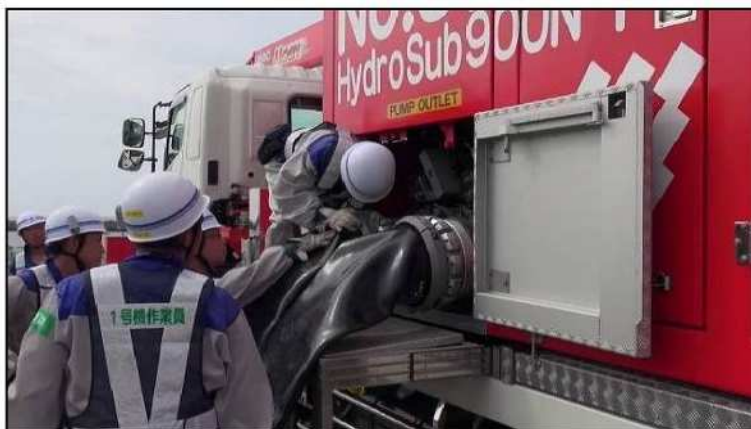
移動式大容量ポンプ車の設置
