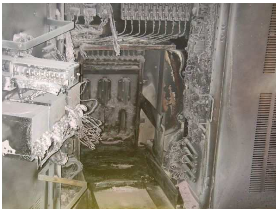
3-1 B 2L 受電盤遮断器室
