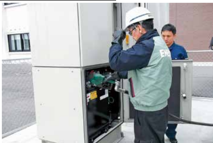
モニタリングポストへの燃料供給訓練
