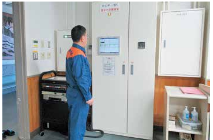
代替オフサイトセンター（消防学校）立ち上げ訓練 （放射性防護設備の稼働）
