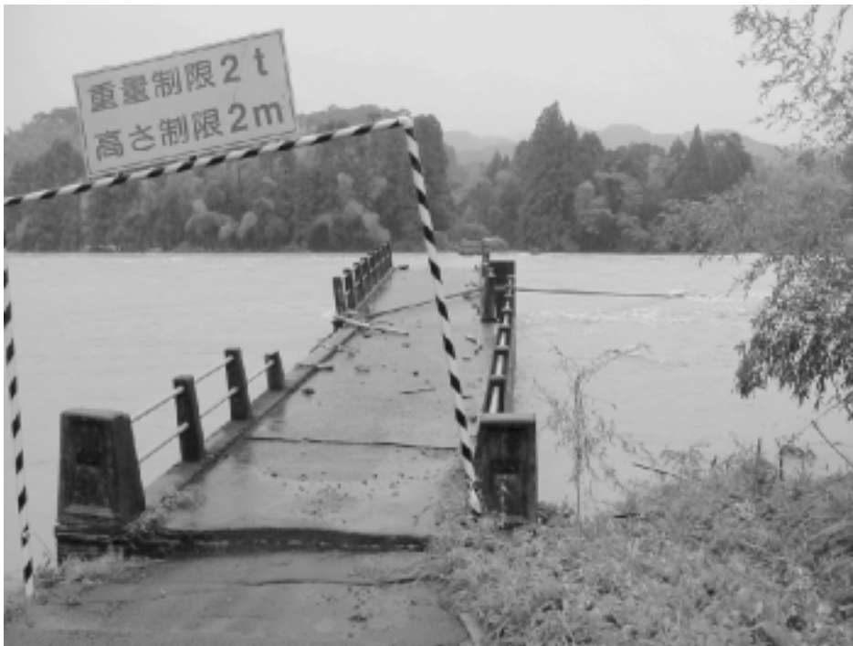
● 流失後の久住橋
