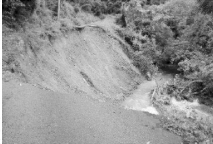
道路の決壊により破断した送水管（本之牟礼地区）
