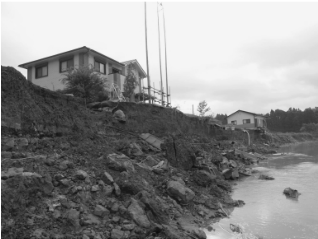
河岸の浸食状況（薩摩川内市東郷町五社下）
