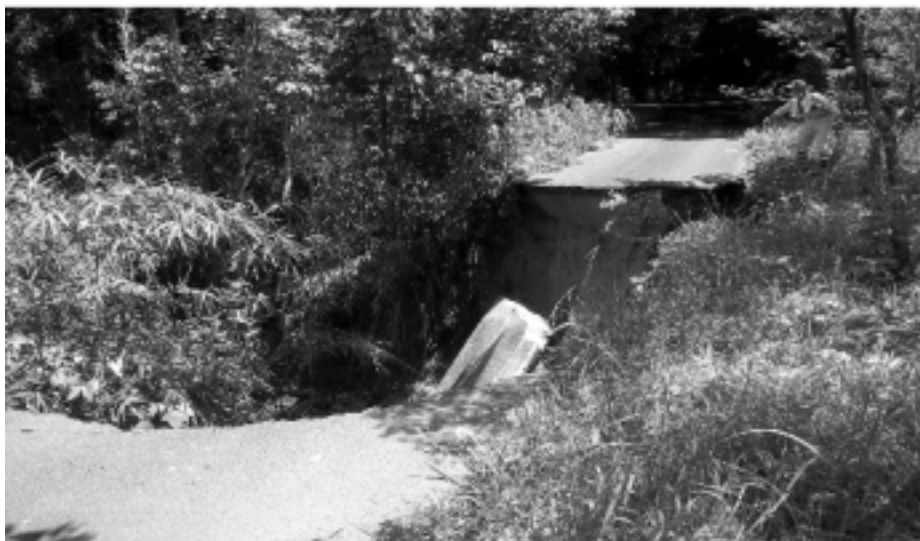
流出した路体【下手線】（菱刈町）
