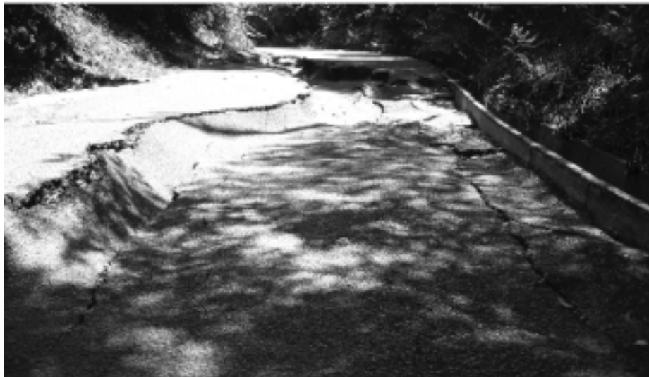
陥没した路面【倉三線】（長島町）
