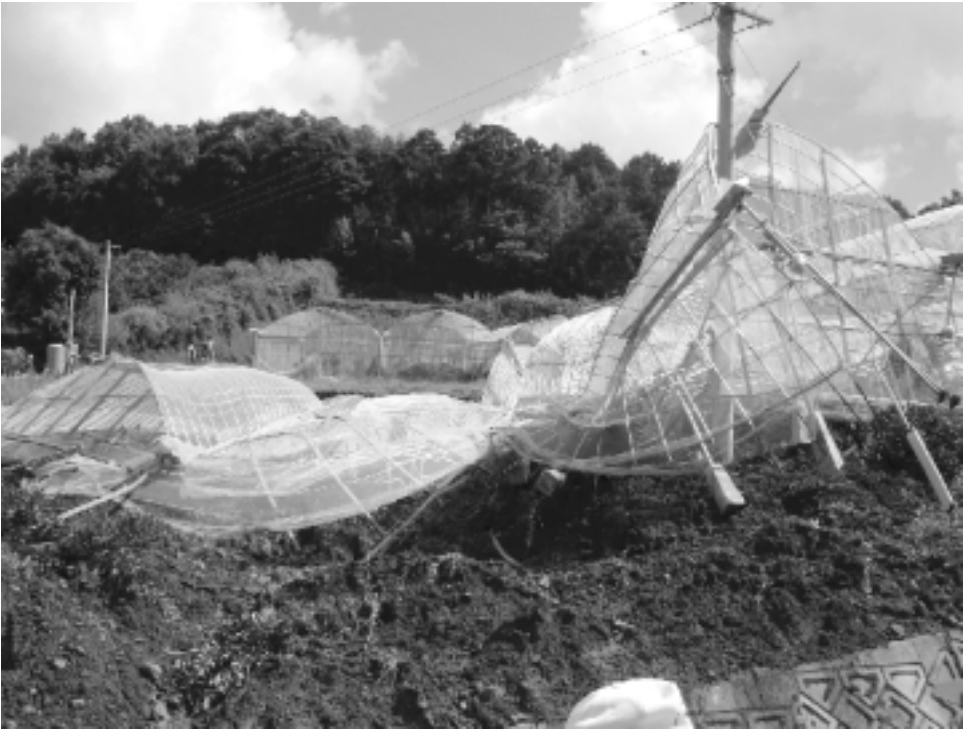
倒壊した不知火（デコポン）のハウス（出水市）
