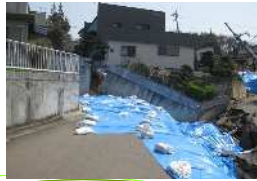
(c)腹付け盛土の崩壊の事例
