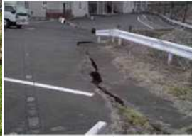
(b)のり肩の亀裂の事例
