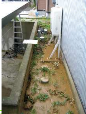
>破裂して水が流出している
