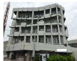
庁舎の被害状況（国土交通省資料）
