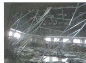
吊り天井の落下（国土交通省資料）
