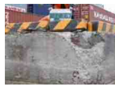
上部工(角部)の欠損
