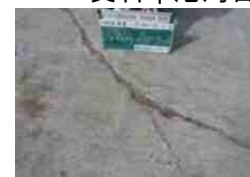
エプロン舗装ひび割れ
