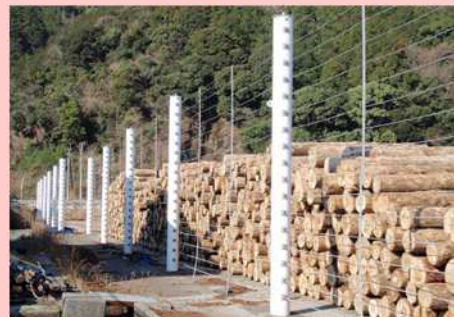
流出防護柵の設置
