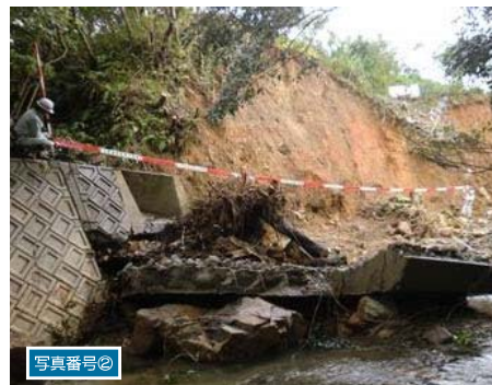
河川施設被災状況
