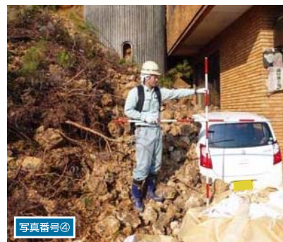
土砂流出状況
