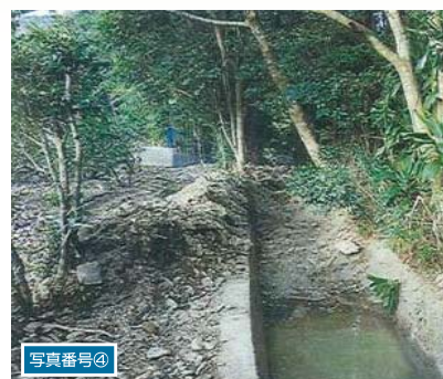
土砂流出状況
