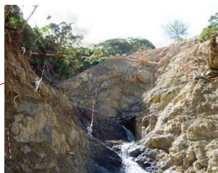
山腹崩壊状況
