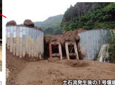
土石流発生後の1号堰堤
