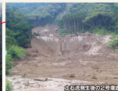
土石流発生後の2号堰堤
