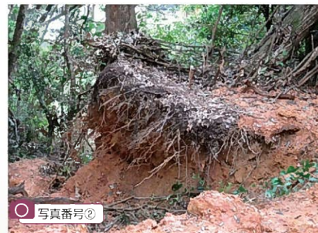
斜面崩壊状況
