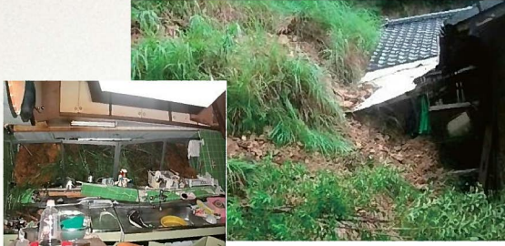
がけ崩れ(さつま町大俣6地区)7月6日発生 住家一部破損 1戸
