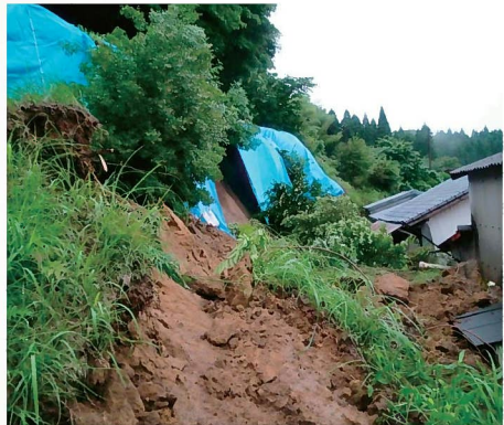
がけ崩れ(薩摩川内市役田地区)6月16日発生 非住家一部破損 1戸
