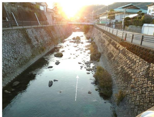
■ 稲荷橋より下流の状況
