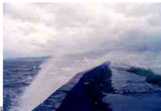
越波による被害2(出水市)
