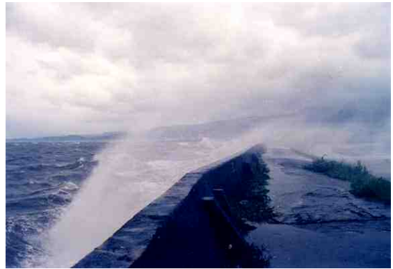
越波による被害2 (出水市)
