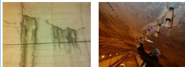
トンネル壁面の老朽化 (ひび割れの発生)
