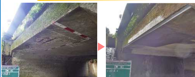
コンクリートの剥落・鉄筋露出
