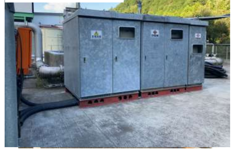
②高圧受電設備
