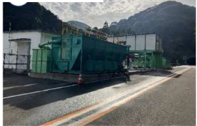
①濁水処理設備
