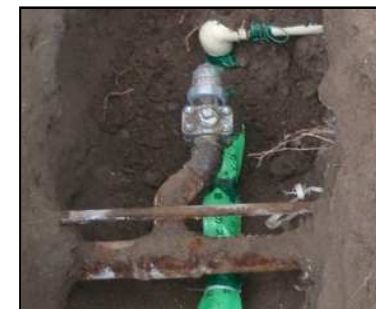
老朽化した埋設管
