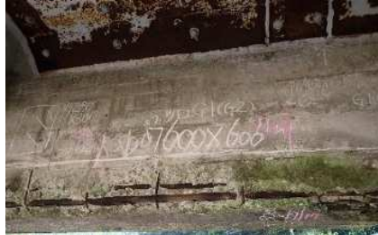
鉄筋露出・破断
