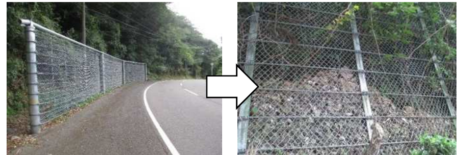
落石防護柵が崩土を捕捉し，通行止めを阻止
