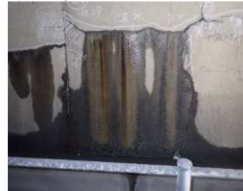
ひび割れからの漏水
