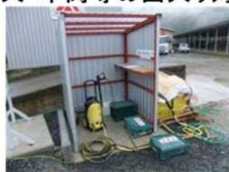
農場出入口における車両消毒設備の設置
