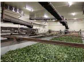
生葉室を断熱材で覆い冷風循環
