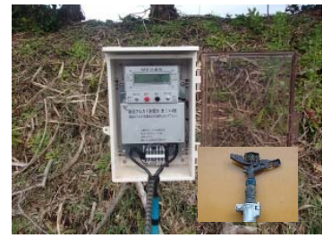
自動散水・止水装置
