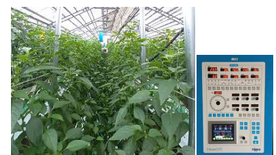
統合環境制御システムの活用(ピーマン)
