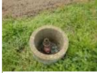
劣化した給水栓
