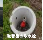
取替後の取水栓
