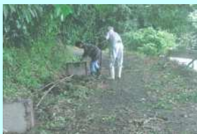
【台風後の現場確認及び泥上げ】
