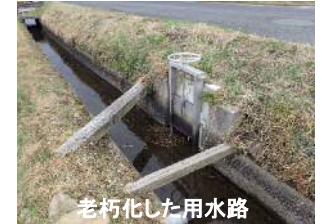
老朽化した用水路
