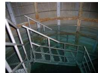
【集水井戸内部】
