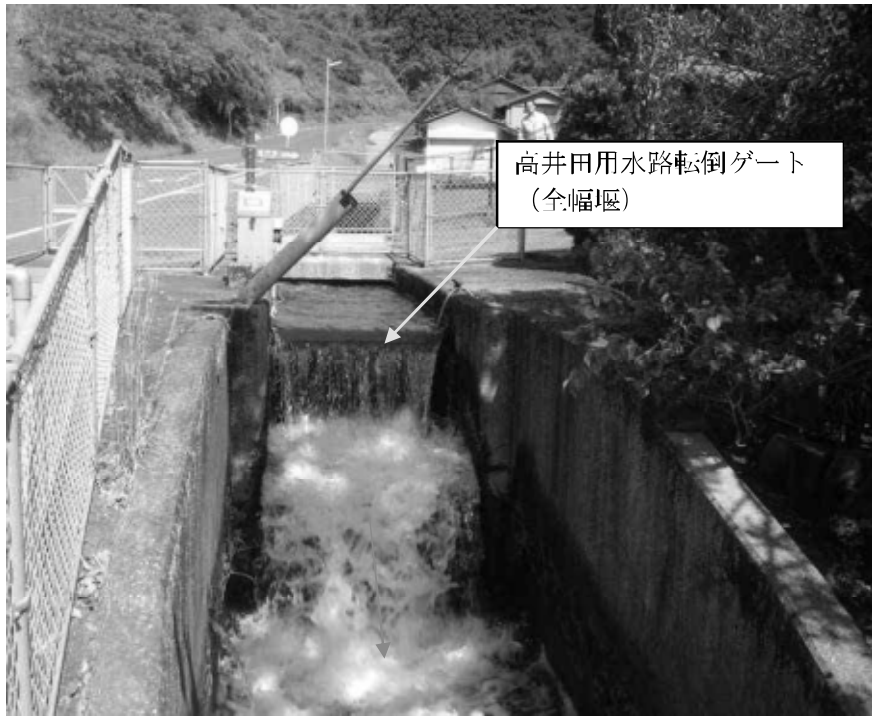
図 4.1-2 龍門滝地区高井田用水路 転倒ゲート
