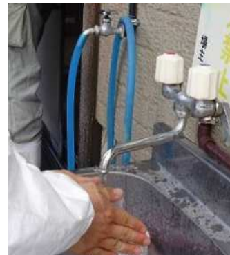
手指の洗浄・消毒が可能な設備の設置
