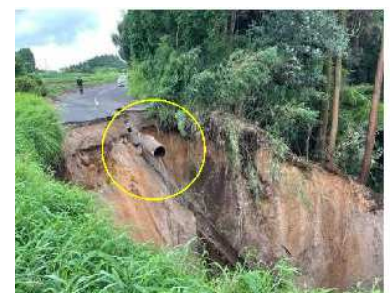
パイプラインの破断
