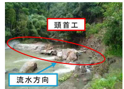
頭首工の崩壊
