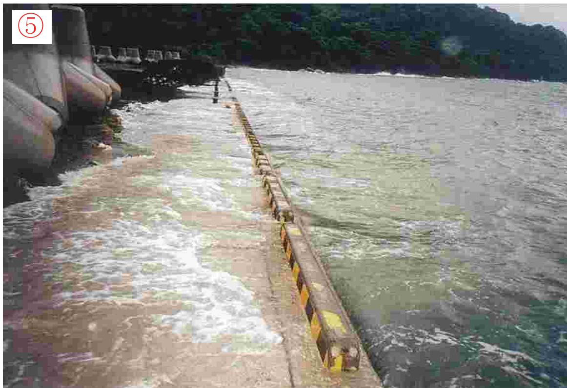
台風接近時、小白木地区の状況。外郭施設の整備が十分でなく、高波により用地に仮置きされていた漁具が流されることがある。
