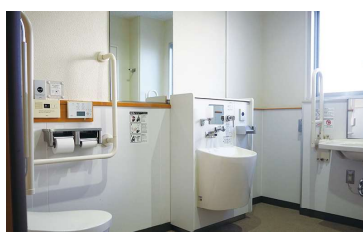
管理棟内の多目的トイレ
