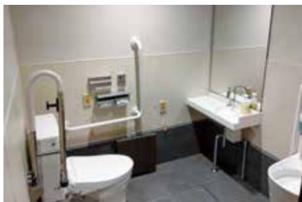
オストメイト設備を有するバリアフリートイレ
