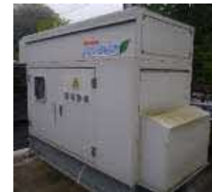
非常用発電機
