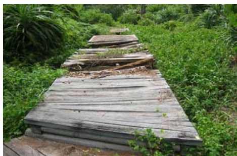
写真3 当初施工箇所と補修箇所
