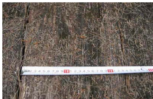
写真 14 隙間間隔の不足
