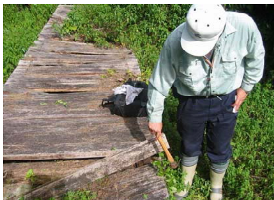
写真6 打撃による損傷確認
