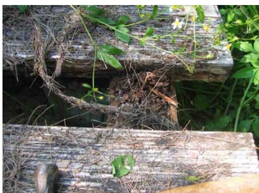
写真 17 床板と根太の腐朽
