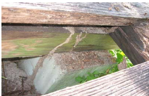
写真7 地中から伸びた蟻道
