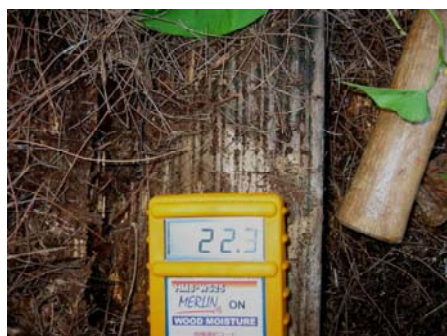
写真9 比較的損傷の少ない床板 (MC22%)
