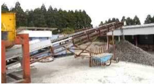
スクリーン通過の製品を ベルトコンベアで排出
