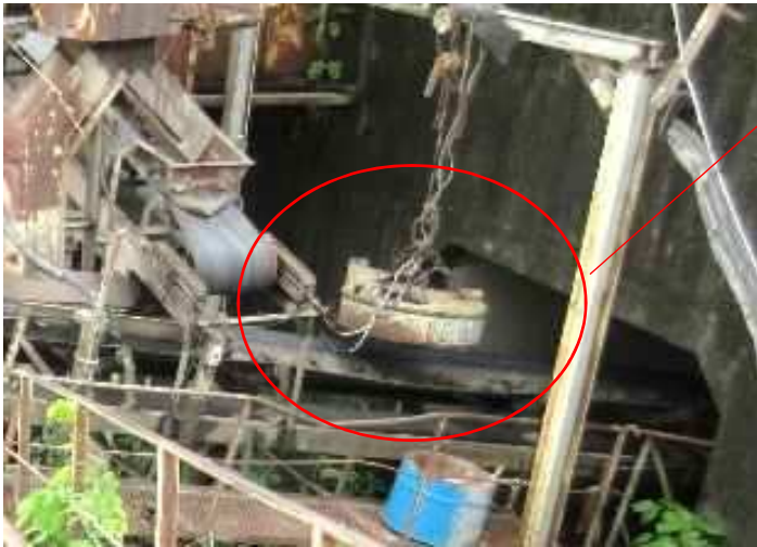
磁選機による金属類の除去
