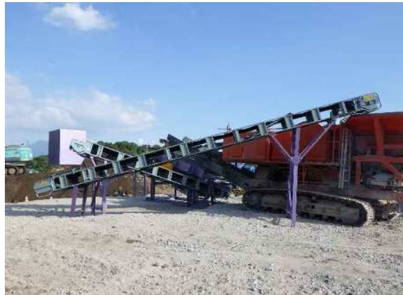
リターンコンベア ・オーバーサイズは 破砕機へリターン
