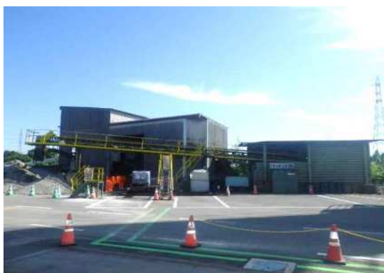
製造施設 ・破碎機、振動篩機は建屋内に設置
