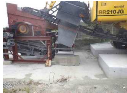
⑦破碎後に磁選機で金属類の除去
