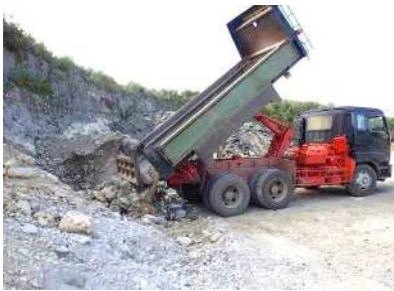
③保管場所 (荷下ろし状況) コンクリートとアスファルトは 混ざらないように保管
