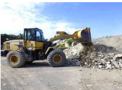
⑤コンクリートとアスファルトの混合 ・小割したコンクリート塊と アスファルト塊を、タイヤ ショベルで5杯、2杯の割合で混合
