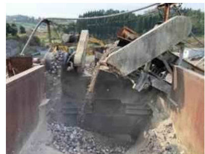
⑧第2クラッシャー ・寿工業製ジョークラッシャー ・ベルトコンベアで第1クラッシャー後の塊を 第2クラッシャーに投入
