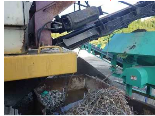
磁選機による金属類除去状況 ・破碎後に磁選機で金属の除去
