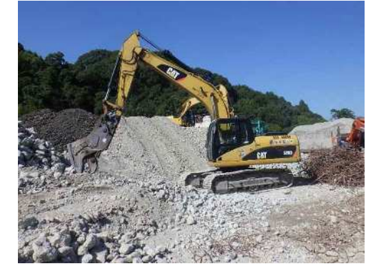
④圧砕機による前処理状況 ・圧搾機で小割するとともに鉄筋や異物の除去を行う
