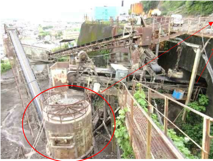
2次破碎 (シュレッダーによる破碎) 2次ストック落ち口
