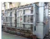
Li-ion電池リサイクル設備
