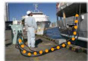
電力供給設備
