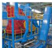
金属破砕・選別設備
